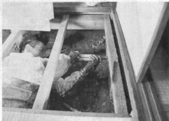
床下に入って基礎部分の強度を測る耐震診断の調査員
